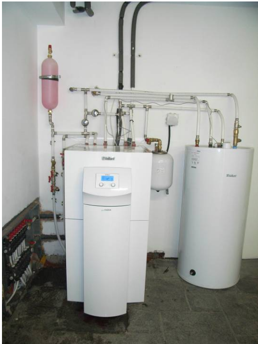
Bomba geotérmica, acumulador y uno de los colectores para el suelo radiante
